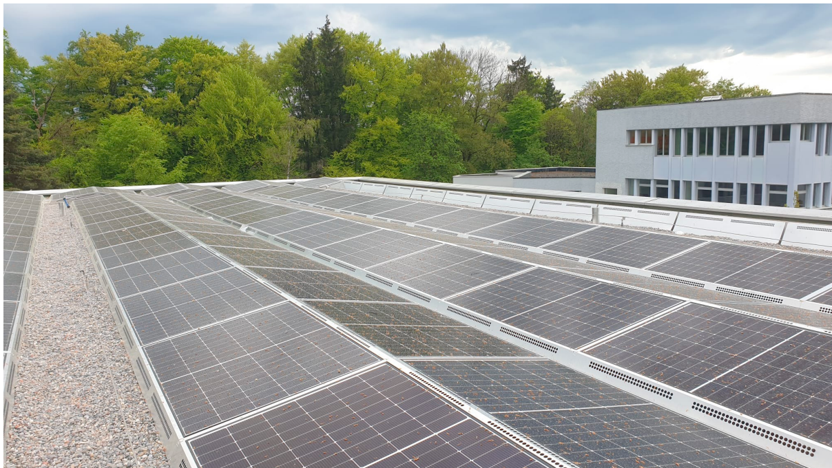
Abb 2: Neue PV Anlage Schulhaus Juch
