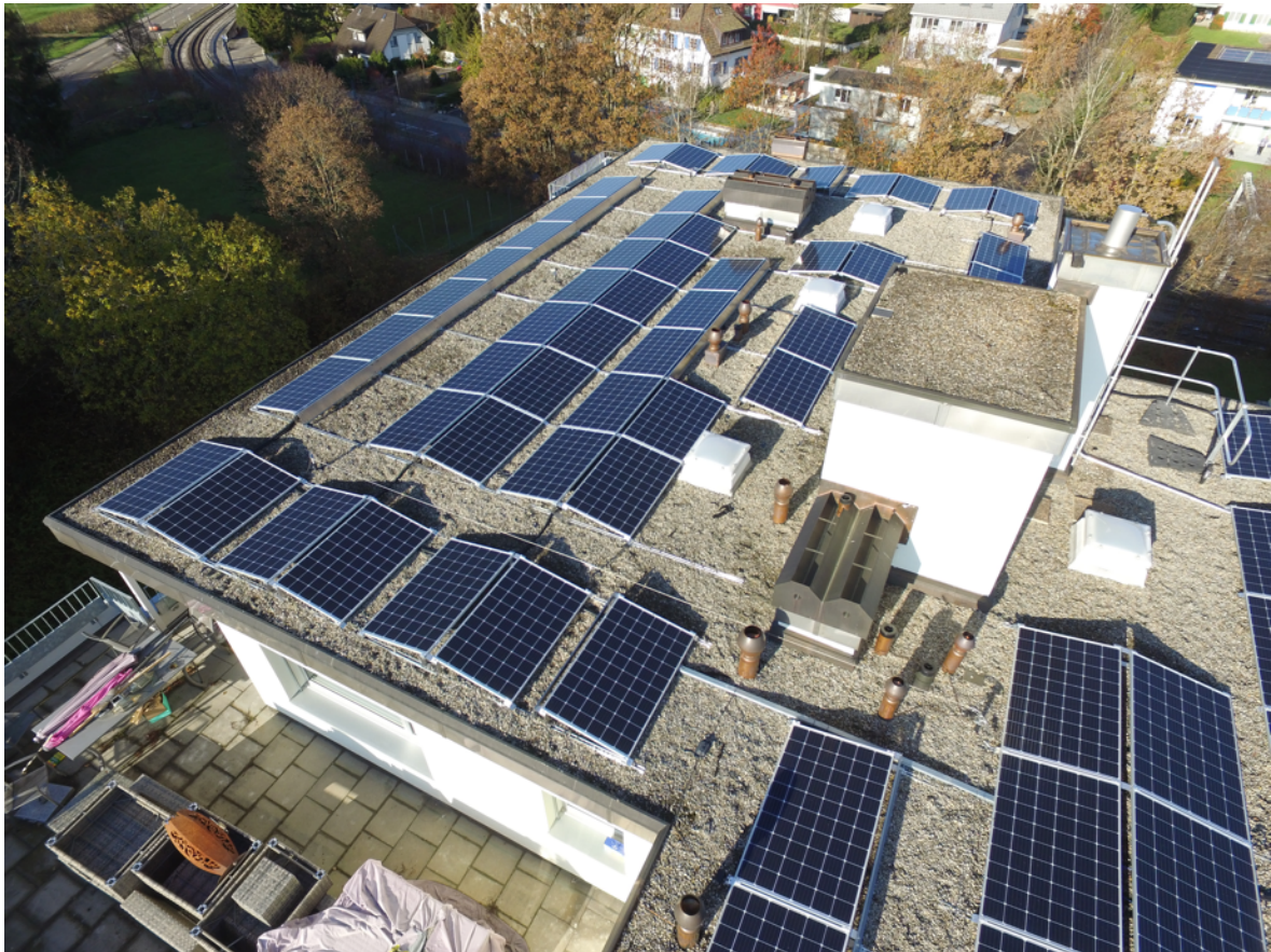
Abb 1: PV Anlage In der Gandstrasse 33 (IdG33)
